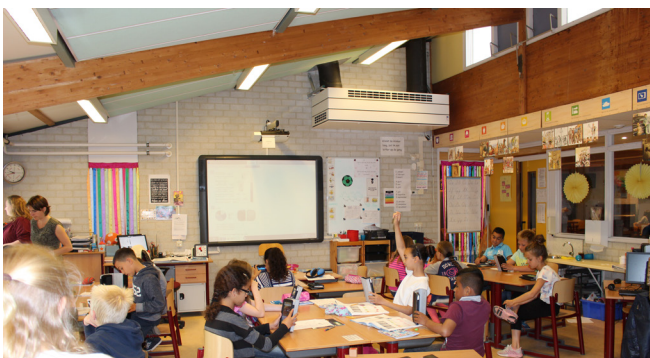
Klaslokaal met decentrale LBK aan het plafond
