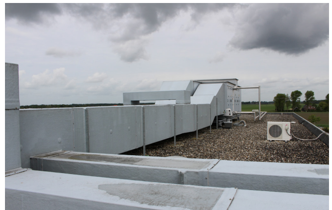
Centrale LBK op het dak
