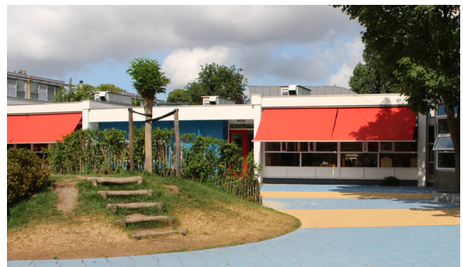
Drie decentrale LBL's op het dak
